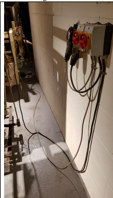
1) nauwe doorgang naar vlasbinder met electa kabels
